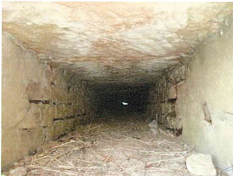
FOTO 7. Intrados degradat podeţ dalat
