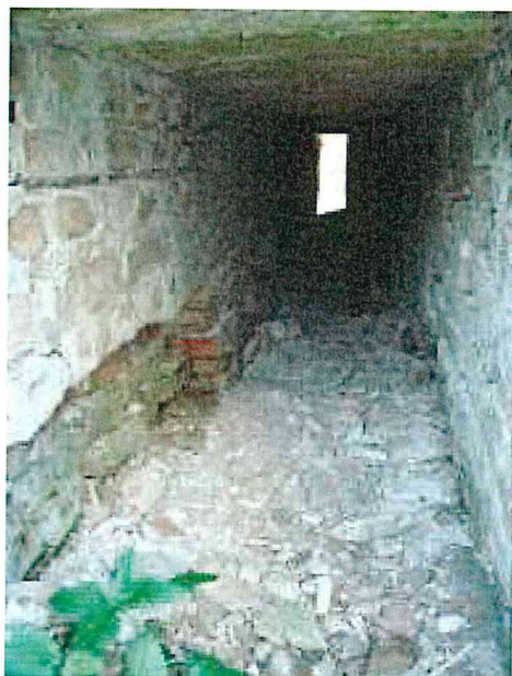
FOTO 2. Interior degradat podeţ
