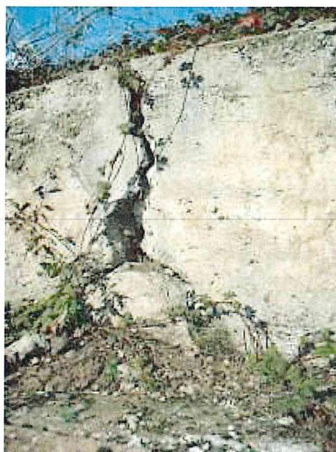
FOTO 8. Detaliu timpan beton fisurat
