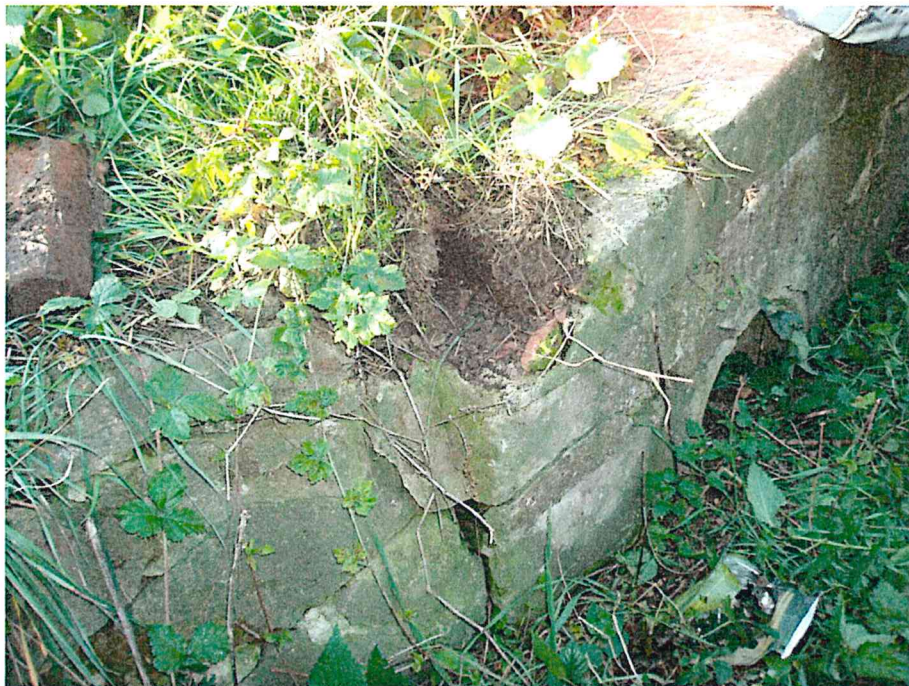
FOTO 6. Degradări zidărie timpan aval
