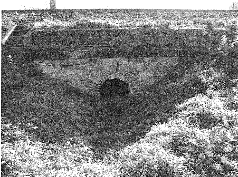
FOTO 1. Vedere stânga timpan poduț cu tencuiala căzută
