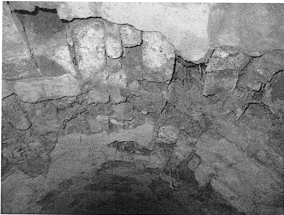
FOTO 4. Intrados boltă cu zidărie degradată
