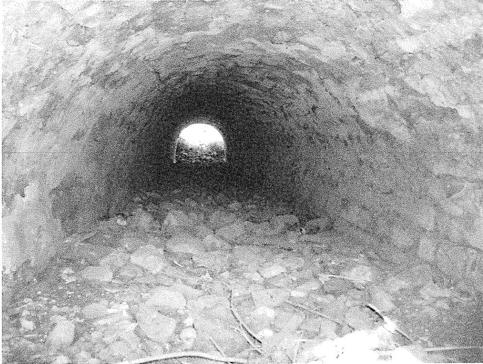
FOTO 3. Intrados podeț boltit și pereu degradat
