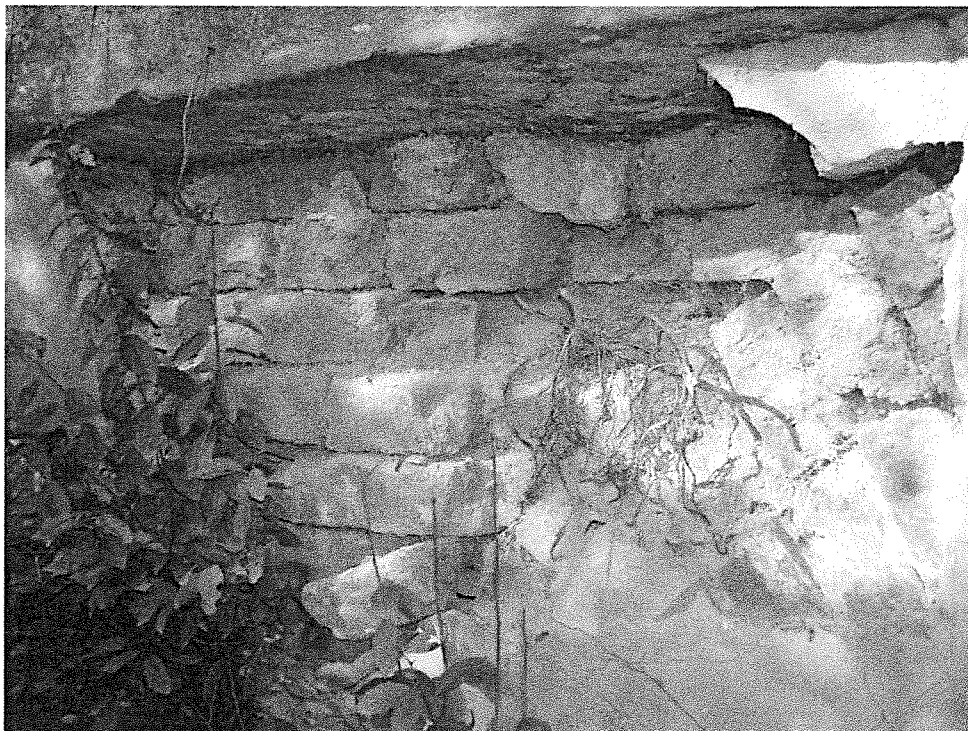
FOTO 7. Timpan cu degradări majore
