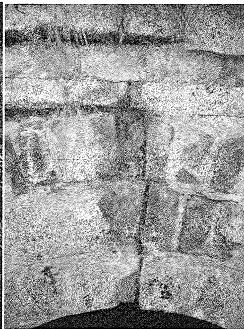
FOTO 6. Deplasări zidărie timpan
