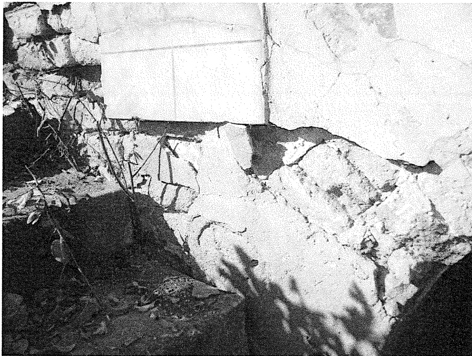
FOTO 2. Timpan dreapta fisurat, cu tencuială căzută
