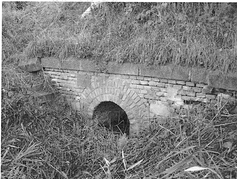
FOTO 1. Timpan aval cu zidărie cărămidă căzută și albie acoperită cu vegetație
