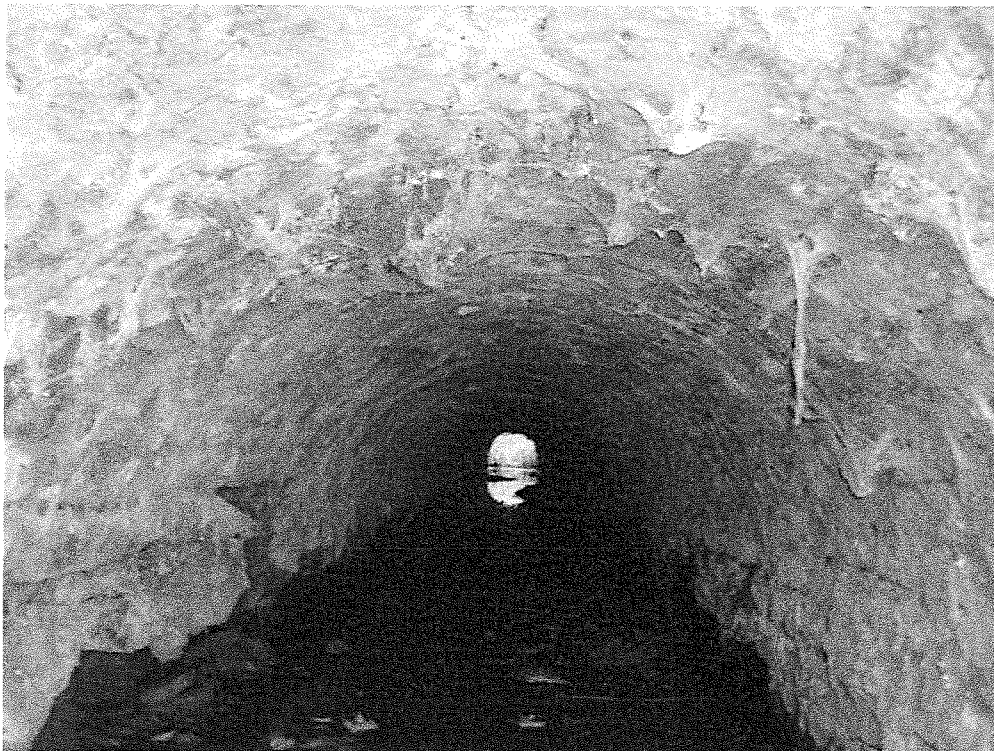
FOTO 4. Intrados amonte podeț (cărămizi desprinse)
