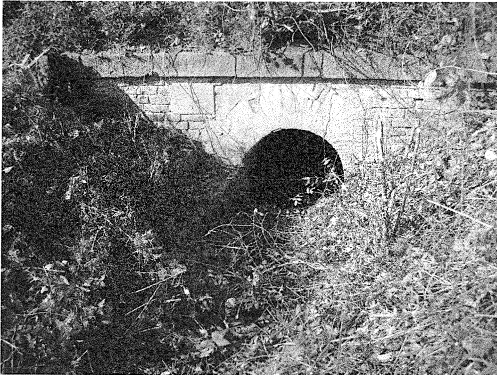
FOTO 3. Timpan amonte și albie acoperită cu vegetație
