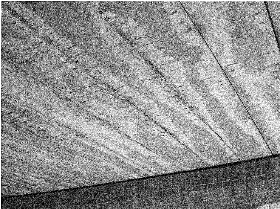
FOTO 4. Armături corodate la partea inferioară a grinzilor fâșii cu goluri
