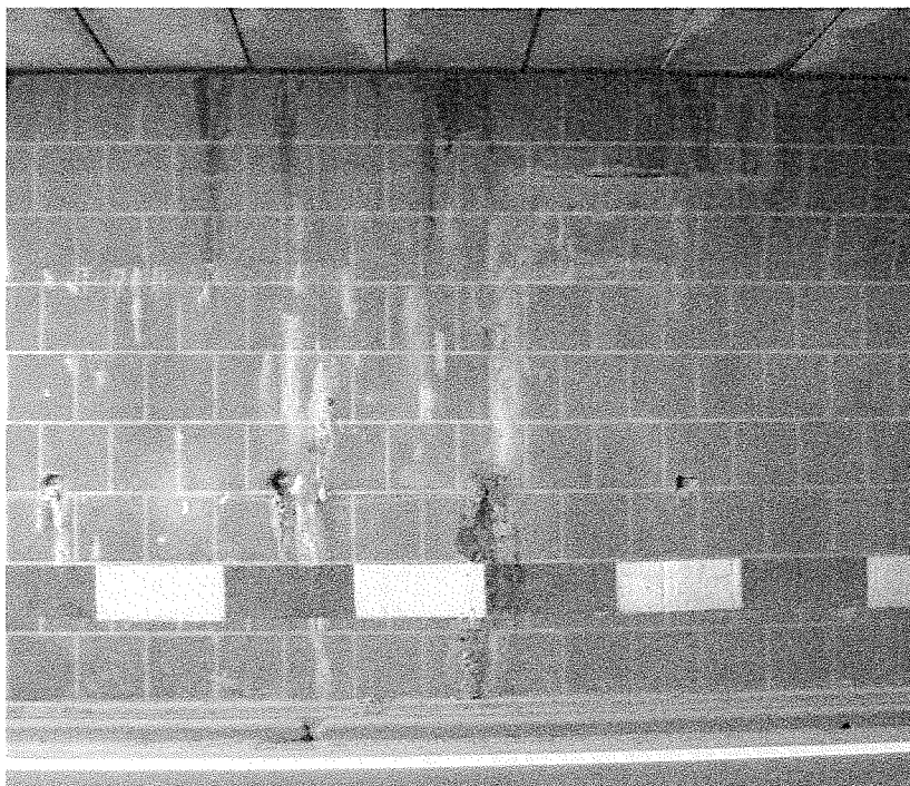
FOTO 8. Defecte de față văzută ale culeelor
