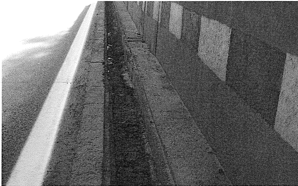
FOTO 7. Lipsă capace la rigolele drumului din interior pasaj
