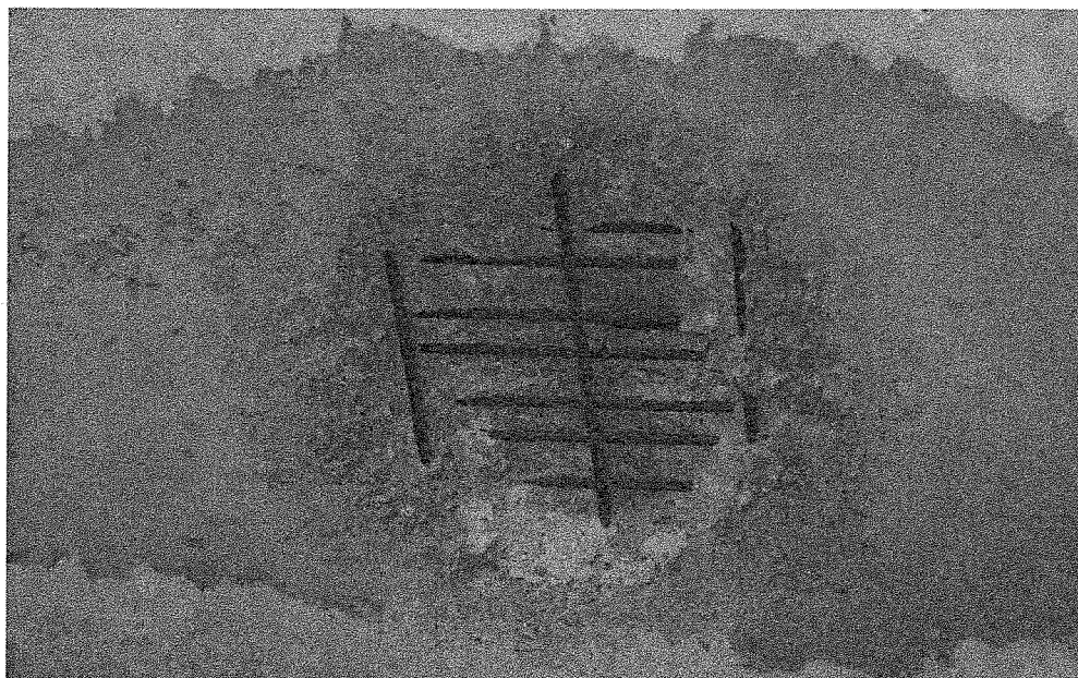
FOTO 5. Segregări și armături corodate la partea inferioară a grinzilor fâșii cu goluri
