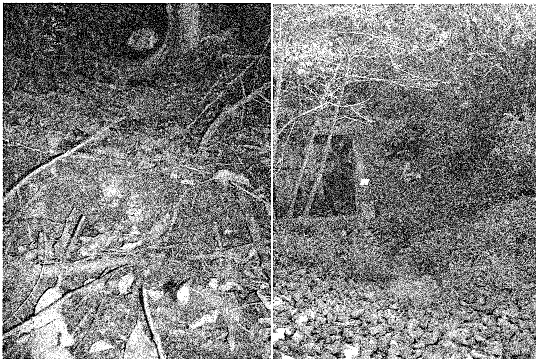
FOTO 6. Amenajare în trepte aval degradată
