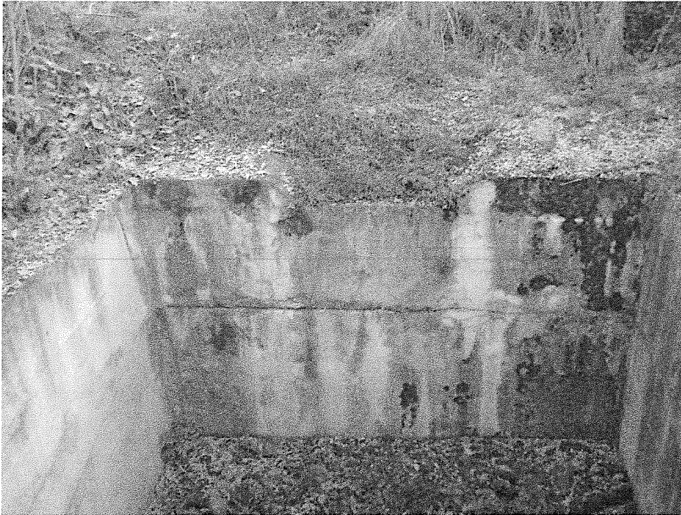
FOTO 5. Camera de cădere amonte
