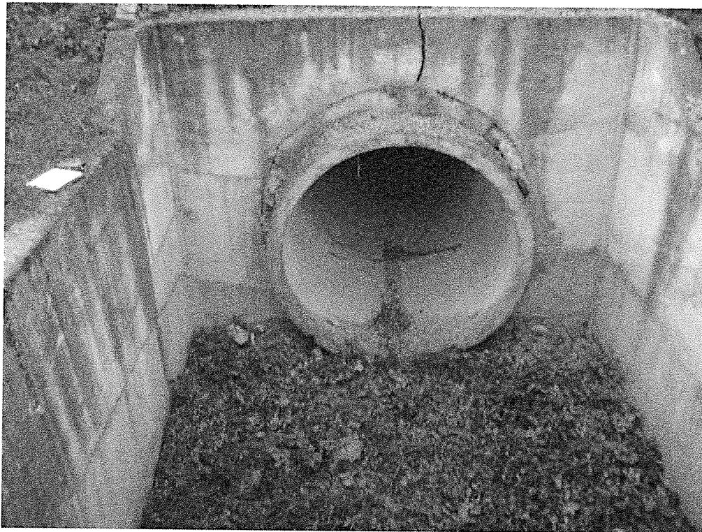
FOTO 4. Camera de cădere amonte
