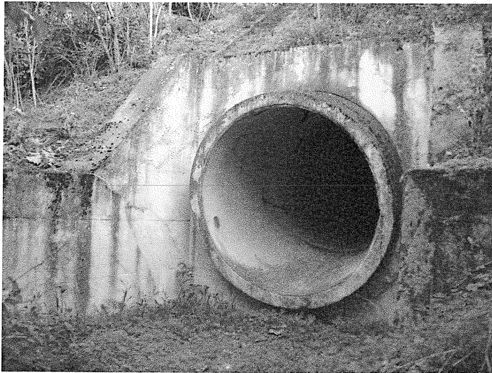
FOTO 1. Ieșire aval podet forat
