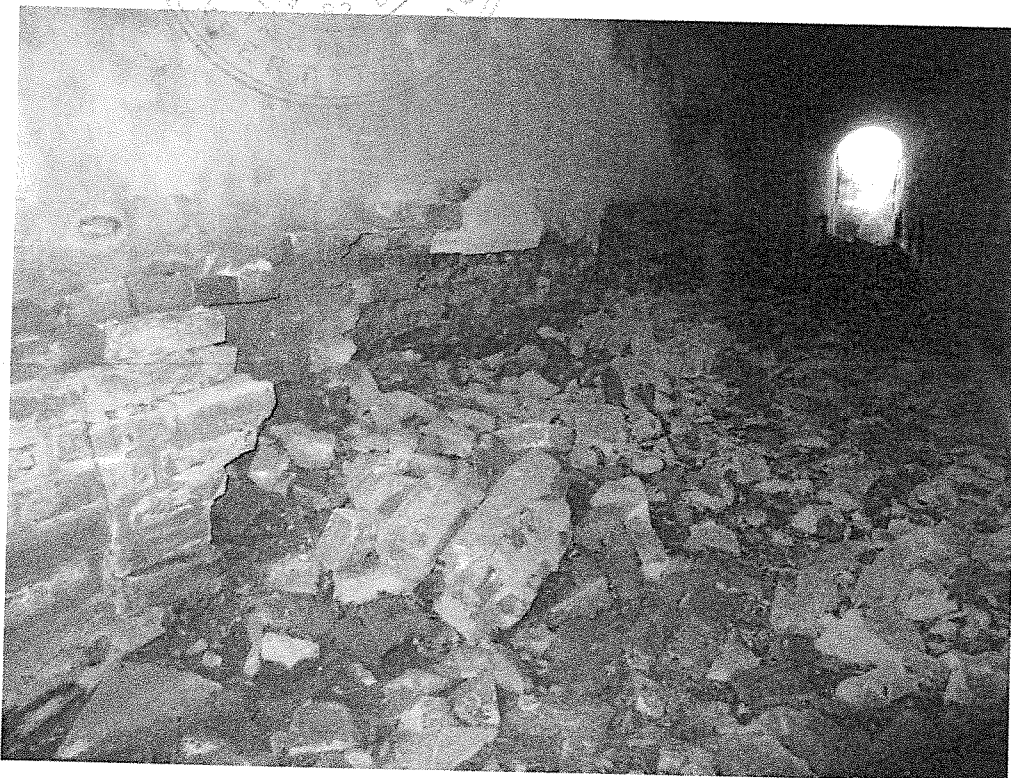
FOTO 7. Interior podeț cu zidărie de cărămidă prăbușită local
