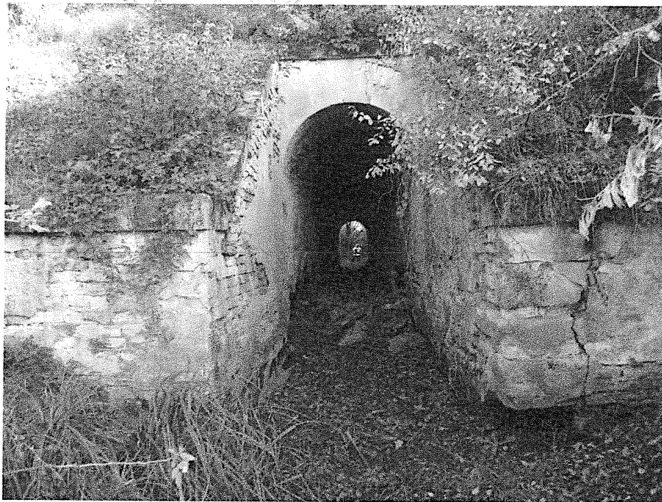
FOTO 1. Timpan stânga ax cf cu aripi din cărămidă degradate
