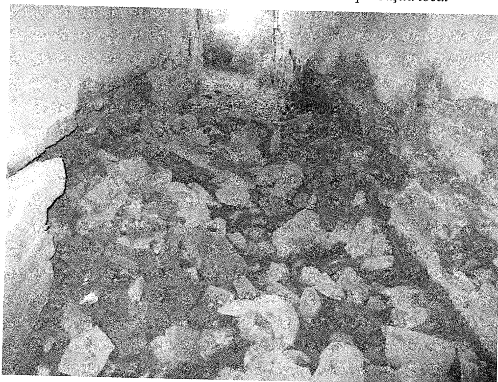
FOTO 8. Interior podeț colmatat cu zidărie de cărămidă prăbușită
