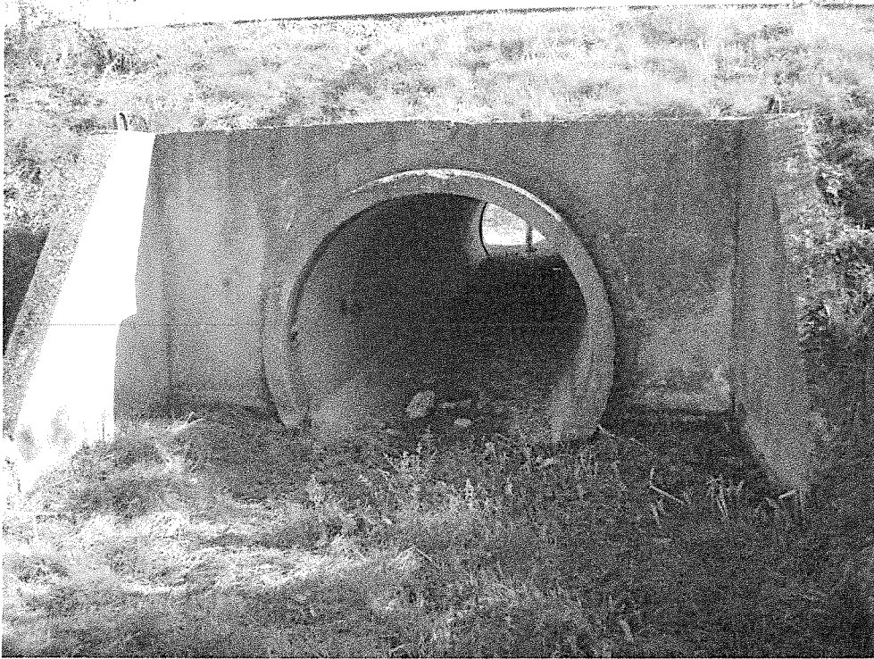
FOTO 4. Vedere amonte podeț forat
