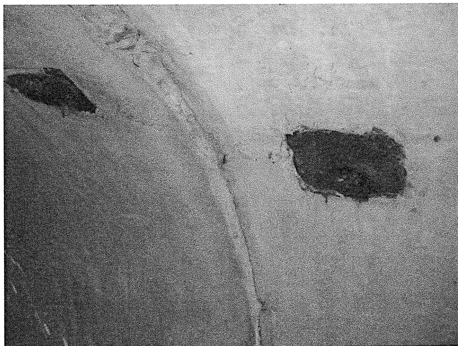
FOTO 8. Degradări la rosturile dintre tuburi
