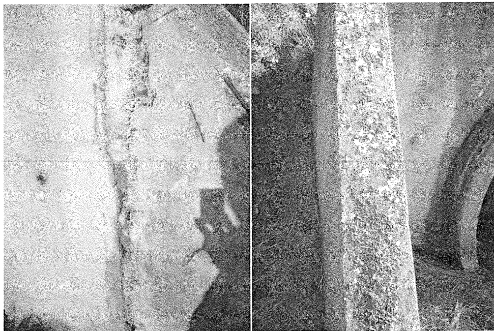
FOTO 6. Degradări racordări aval
