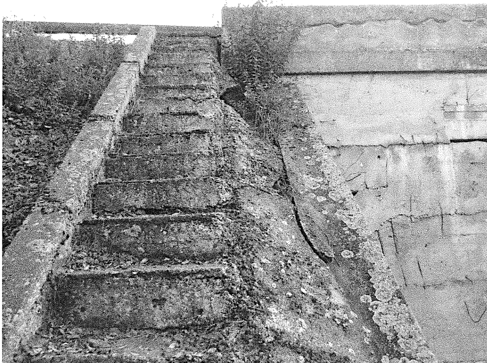
FOTO 8. Scări acces și aripi degradate
