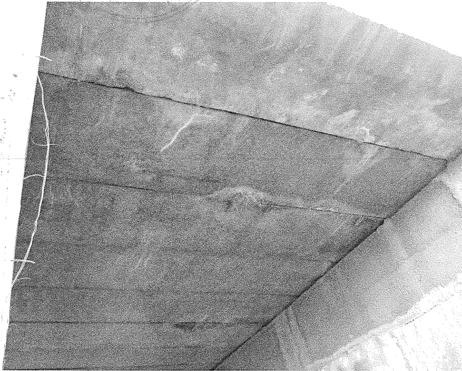
FOTO 7. Intrados dale cu infiltrații
