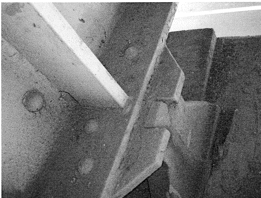
FOTO 8. Aparate de reazem afectate de coroziune
