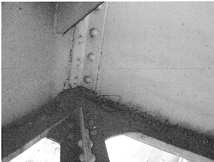
FOTO 5. Coroziuni la tălpile inferioare
