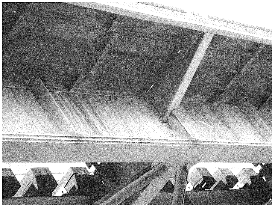
FOTO 6. Coroziune la dulapii de trotuar
