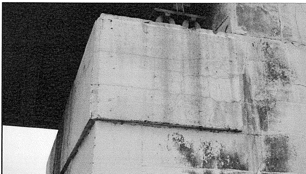
FOTO 23. Fisuri banchetă, culeea Arad
