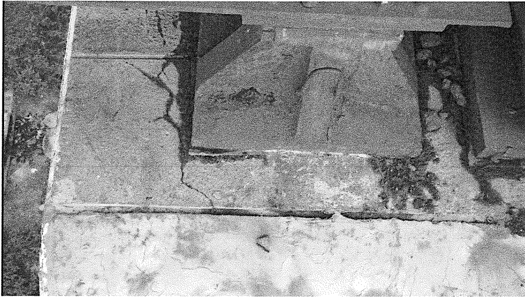
FOTO 15. Cuzinet fisurat și aparate de reazem
