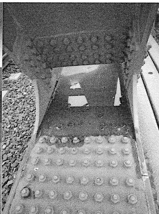
FOTO 4. Exfolieri ale protecției anticorozive
