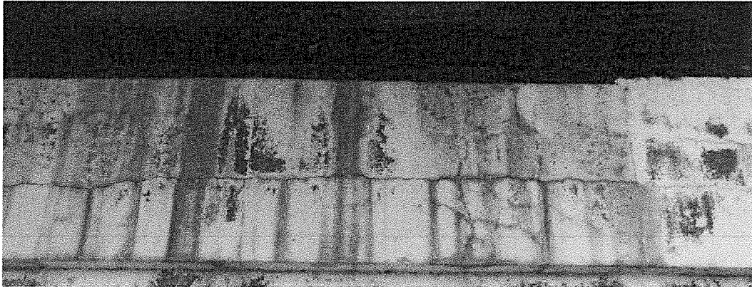
FOTO 17. Vedere din față, fisuri pila 3
