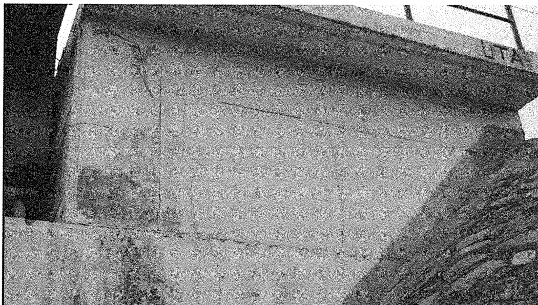
FOTO 22. Fisuri zid întors stânga, culeea Arad
