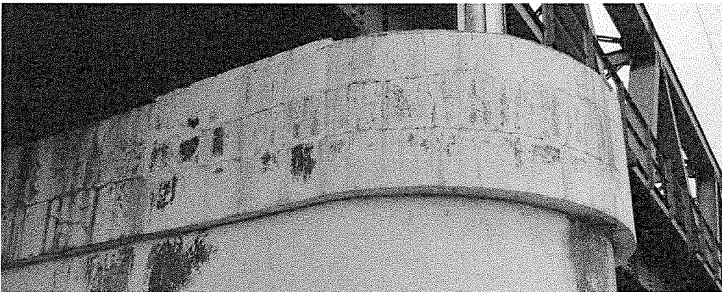
FOTO 18. Fisuri banchetă cuzineți, pila 3
