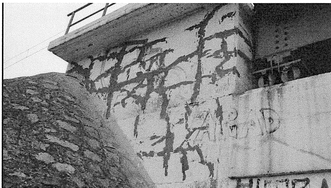
FOTO 21. Fisuri zid întors dreapta, culeea Arad
