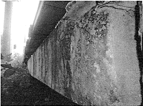
FOTO 8. Infiltrații și beton degradat
