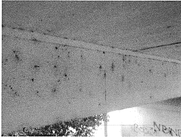
FOTO 6. Defecte beton suprastructură
