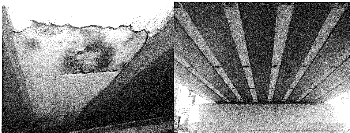
FOTO 4 și 5. Defecte beton suprastructură
