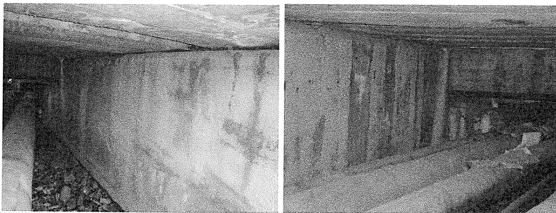
FOTO 5 și 6. Defecte beton suprastructură și infrastructură
