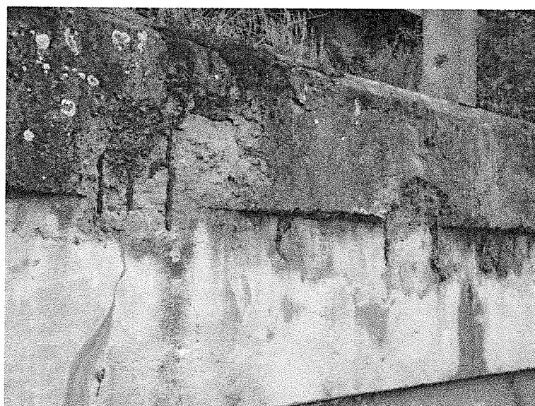
FOTO 7. Beton degradat timpan
