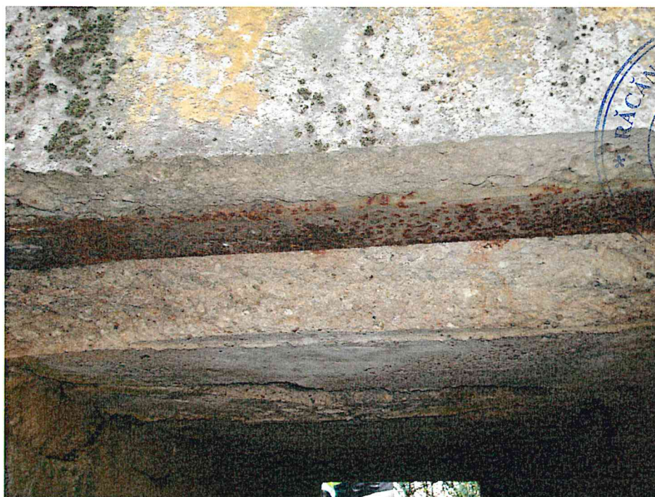
FOTO 2. Timpan și intrados dală degradate, rugină de la grinzi
