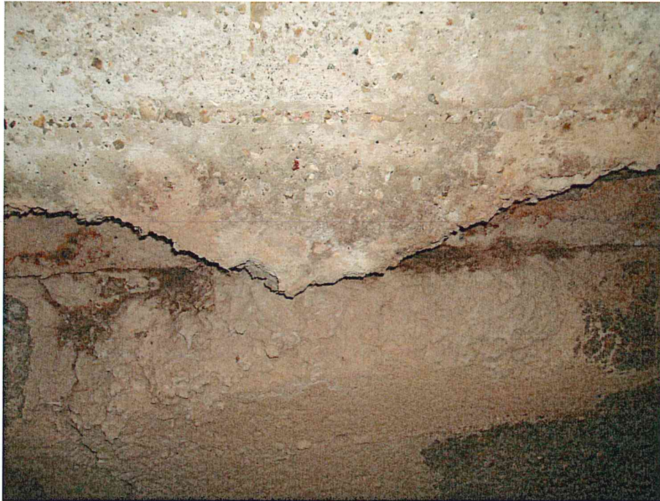
FOTO 3. Grindă metalică I la vedere, ruginită
