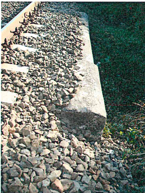
FOTO 4. Timpan cu înălțime insuficientă
