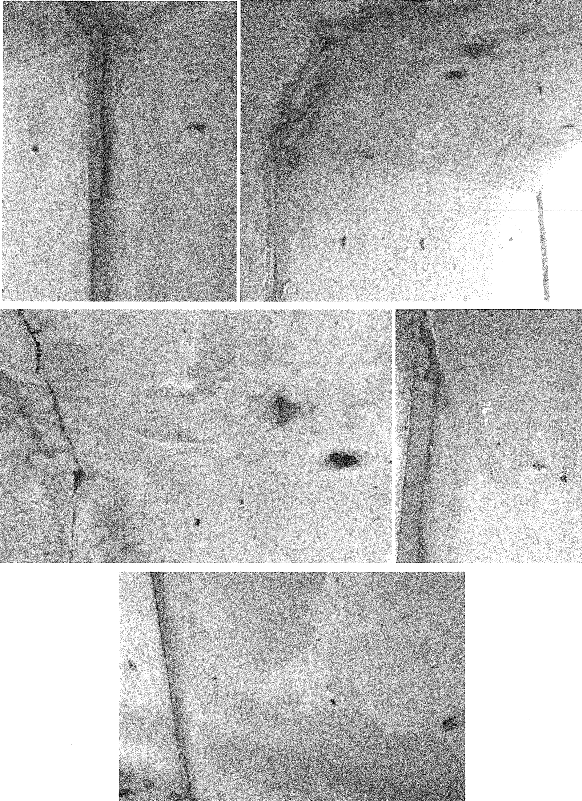
FOTO 3.b. Pozări defectuoase, cadre deplasate, rosturi deschise și defecțiuni ale cadrelor prefabricate din beton
