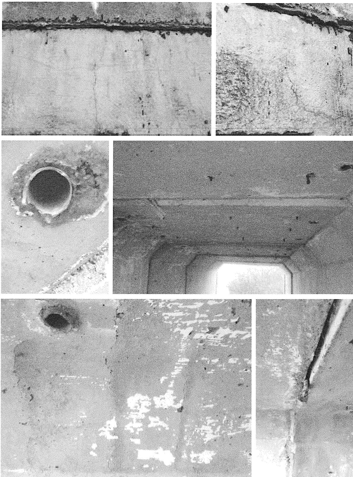
FOTO 3.a. Pozări defectuoase, cadre deplasate, rosturi deschise și defecțiuni ale cadrelor prefabricate din beton
