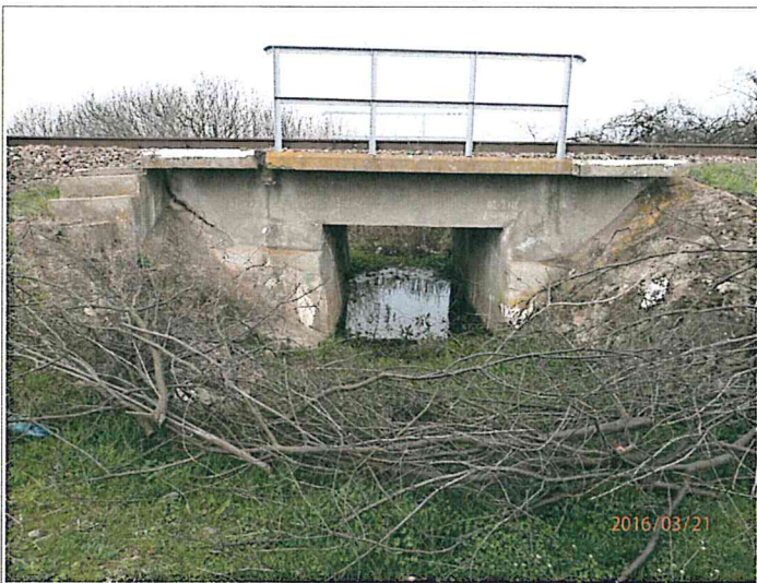
Foto nr.9-Degradari podet km 499+392
