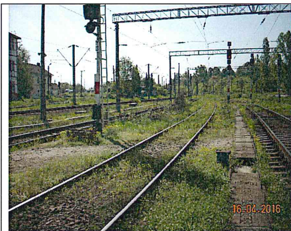
km 476+150 vedere spre cap X stație - prism de piatră sparta colmatat până la nivelul NST, acoperit de vegetație
