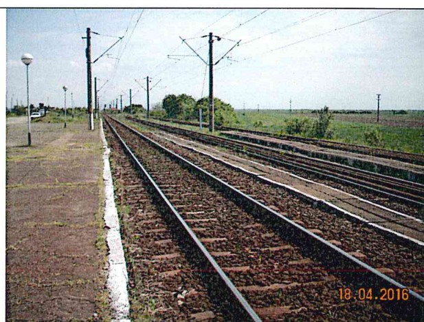
Km 532+750 vedere spre capul X – peroane degradate și dimensiunile nu corespund normelor în vigoare
