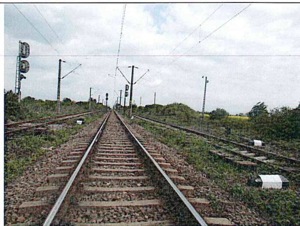
Km 39+450 vedere spre capul Y al statiei – traverse fisurate, lipsa santurilor
