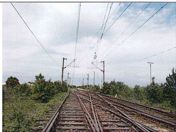
Km 13+780 – bretea in capul Y al stației, traverse de lemn fisurate și crapate, lipsa santurilor
