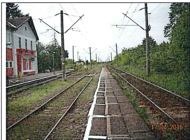
Km 503+650 vedere spre Lugoj – peroane nu corespund cerințelor din normele în vigoare, prismul de piatră spartă colmatat
