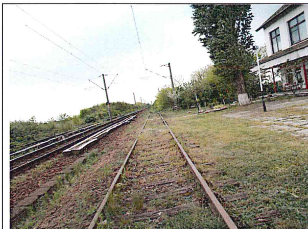
Km 45+600 – prisma caii colmatata, peroane improvizate si degradate
