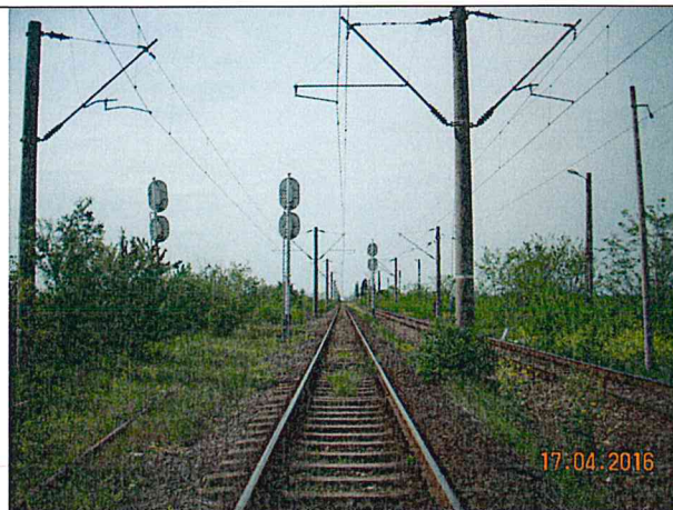
Km 479+500 vedere spre capul Y al statiei – linia 3 acoperita in intregime de vegetatie, prezenta arbustilor in gabaritul c.f.
