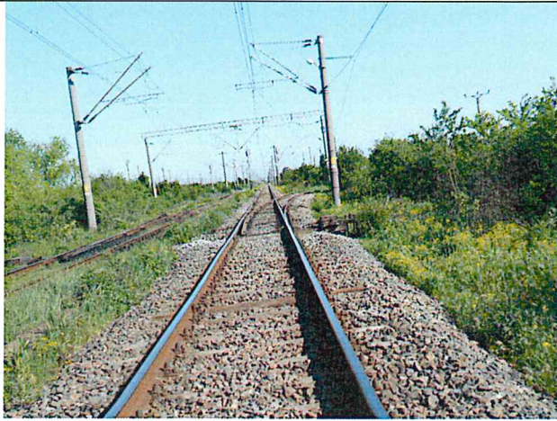
Km 6+400 vedere spre axul stației – lipsa santuri, arbori pe terasamentul c.f.
