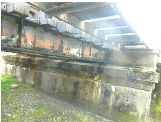
5. Vedere culee C1 – culoare neuniformă, pete, infiltrații, exfolieri, mușchi crescuți pe elevația culeei. Fenomene de coroziune și exfolieri ale vopselei la tablierul metalic.
