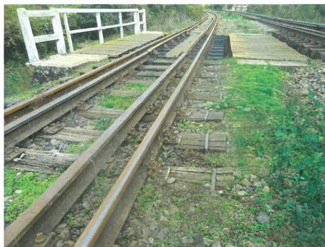
2. Vedere pod spre Aeroport Traian Vuia – traversele de pe zona de racordare sunt total degradate, putrede. Vegetație crescută între linii.
