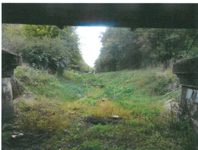
16. Vedere albie aval de podul alăturat – vegetație crescută în albie, depuneri de aluviuni și gunoaie în zona podului.
