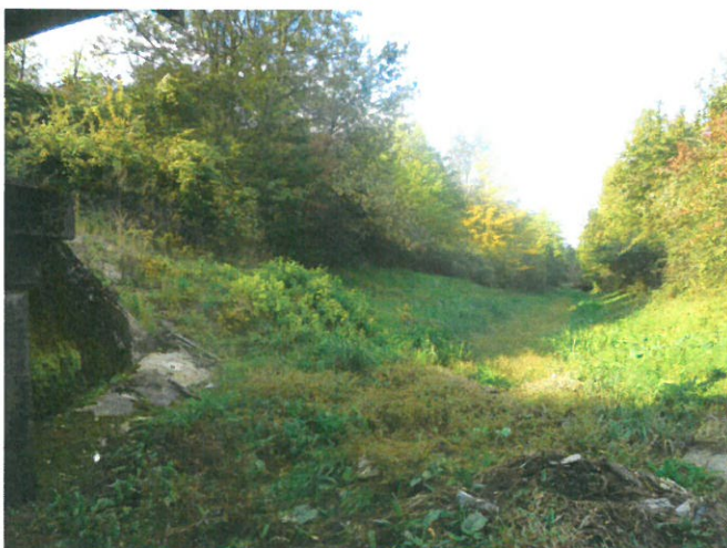
15. Vedere albie amonte de pod – vegetație crescută în albie, depuneri de aluviuni și gunoaie în zona podului.
