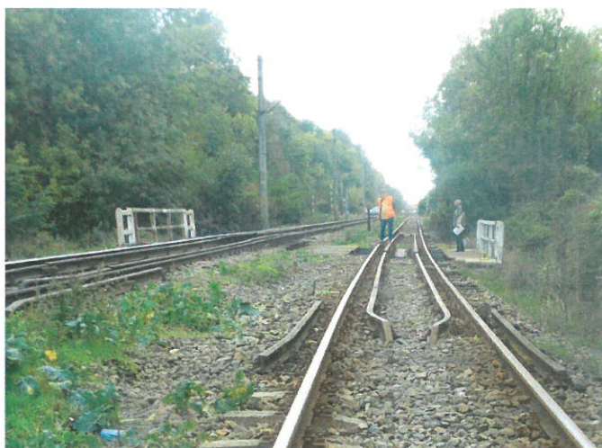
1. Vedere pod spre Timișoara Est – vegetație crescută între linii. (Podul expertizat este cel de pe partea dreaptă)
