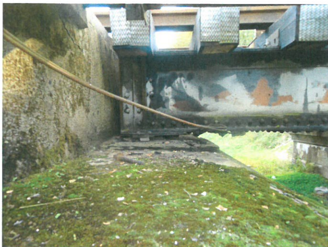
9. Culee C2, detaliu de rezemare – culoare neuniformă, pete, exfolieri, mușchi crescuți pe bancheta cuzineților. Fenomene de coroziune și exfolieri ale vopselei la tablierul metalic.
