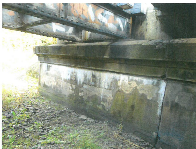
6. Vedere culee C2 – culoare neuniformă, pete, infiltrații, exfolieri, carbonatări, muchii ciobite, mușchi crescuți pe elevația culeei. Fenomene de coroziune și exfolieri ale vopselei la tablierul metalic. Rostul dintre cele două poduri este degradat.
