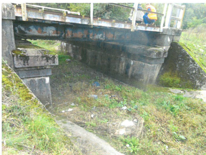
3. Vedere pod din amonte – culoare neuniformă, pete, infiltrații, exfolieri, mușchi crescuți pe elevațiile culeelor și aripilor. Fenomene de coroziune și exfolieri ale vopselei la tablierul metalic. Depuneri de aluviuni în albie.
