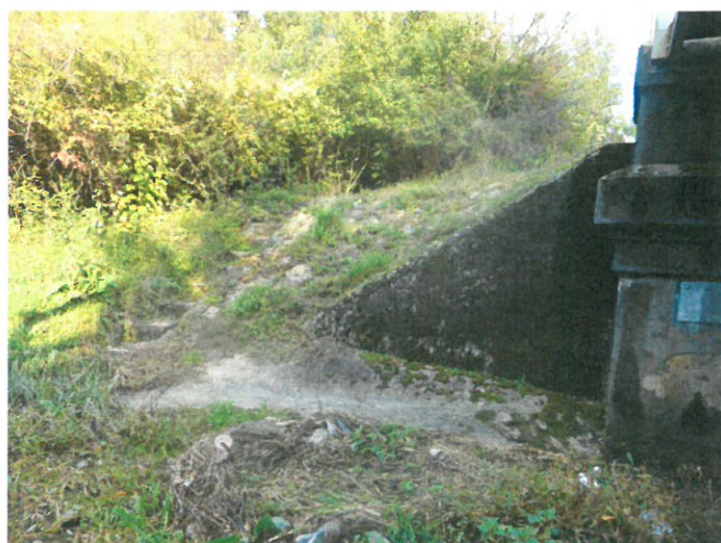
8. Culee C2, racordare cu terasamentele – culoare neuniformă, pete, exfolieri, mușchi crescuți pe elevația culeei și aripilor. Scara de acces și taluzul preeat sunt acoperite de vegetație. Depuneri de aluviuni și gunoaie în albăie.
