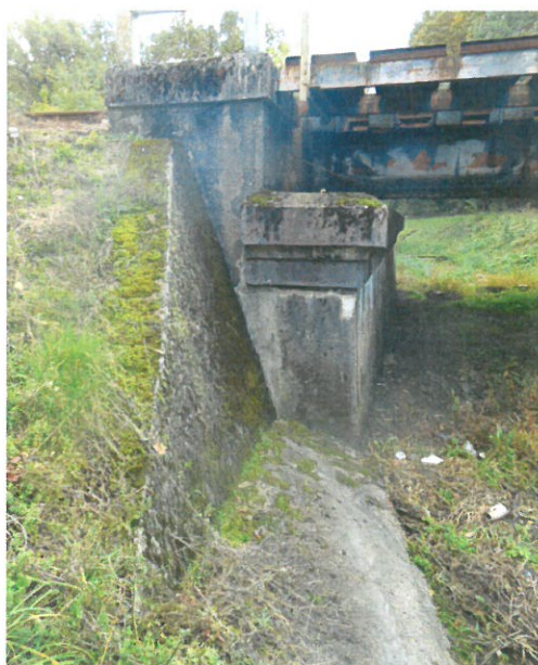
7. Culee C2, racordare cu terasamentele – culoare neuniformă, pete, exfolieri, mușchi crescuți pe elevațiile culeelor și aripilor. Vegetație crescută pe zona de racordare.
