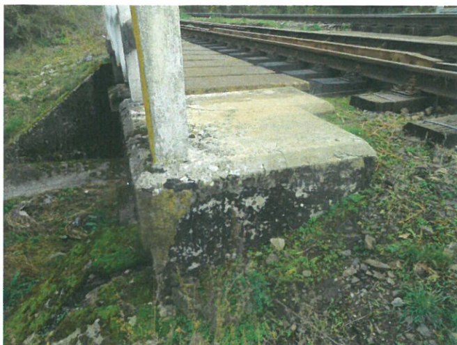
13. Culee C1, zid întors – culoare neuniformă, pete, fisuri, exfolieri beton. Trecerea de pe terasamentul căii ferate pe trotuarul podului este necorespunzătoare.
