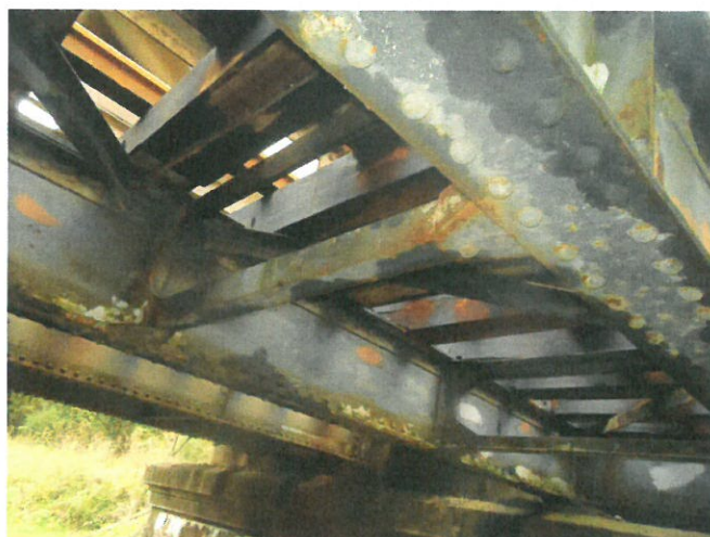
10. Intrados tablier – fenomene de coroziune și exfolieri ale vopselei la tablierul metalic, în special, în zonele de îmbinare a elementelor metalice.
