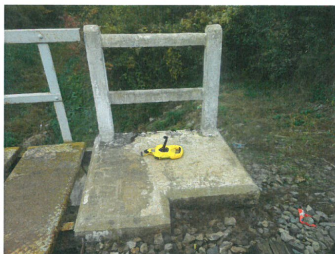
12. Culee C2, zid întors – culoare neuniformă, pete, fisuri, exfolieri beton.
