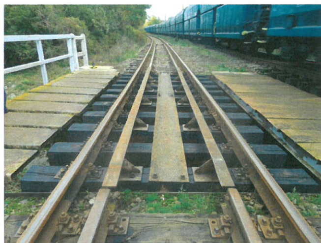
4. Suprastructură pod – fenomene de coroziune și exfolieri ale vopselei la elementele metalice ale tablierul. Traversele de pe pod au fost înlocuite recent.
