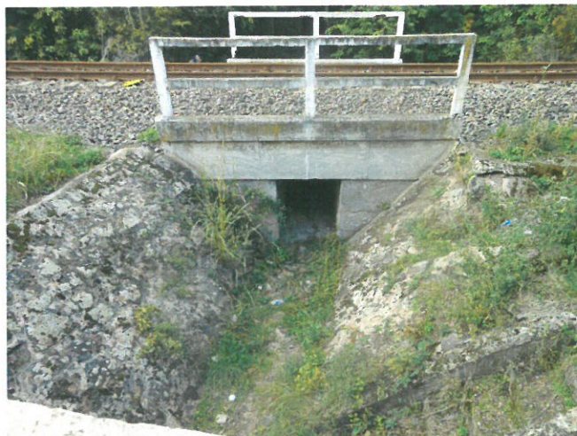
2. Vedere podeț din aval – culoare neuniformă, pete, vegetație crescută pe pereul din piatră. Degradări locale ale pereului din piatră.
