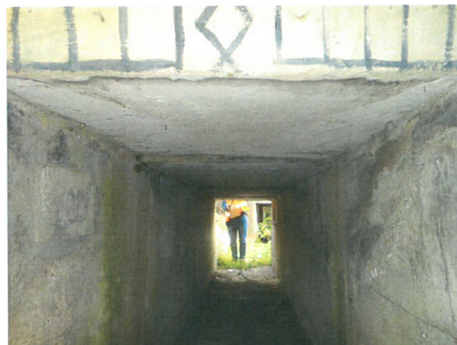
4. Vedere interior podeț din amonte – culoare neuniformă, pete, infiltrații, muchii ciobite, exfolieri beton.
