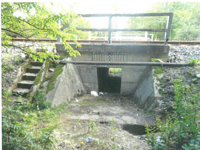
1. Vedere podeț din amonte – culoare neuniformă, pete, mușchi și vegetație crescute pe elevațiile aripilor.
