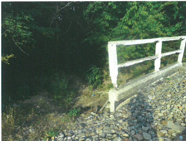
6. Vedere amonte de podeț – parapet de protecție din beton într-o stare avansată de degradare, culoare neuniformă, pete, muchii ciobite, exfolieri beton timpan. Albie neamenajată, vegetație crescută în albie, inclusiv arbuști și copaci.
