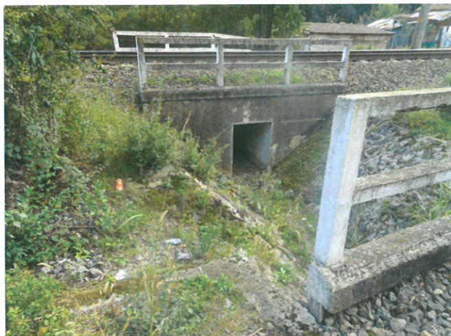
3. Vedere aval de podeț – existența unui alt podeț dalat la 5.85m distanță față de podețul expertizat. Degradări locale ale pereului din piatră și vegetație crescută pe pereul din piatră.
