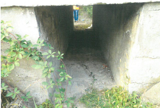
5. Vedere interior podeț din aval – culoare neuniformă, pete, infiltrații, muchii ciobite, exfolieri beton.
