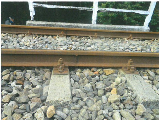
7. Suprastructura căii ferate pe podeț – o parte din traverse sunt fisurate.
