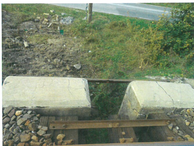
7. Vedere amonte de podeț – lipsă parapet de protecție. Fisuri, crăpături, exfolieri beton timpan. Albie neamenajată.
