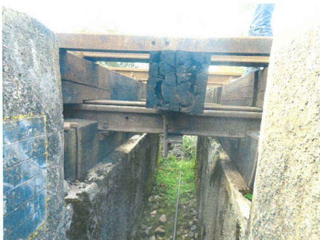
5. Vedere podeț – culoare neuniformă, pete, mușchi, muchii ciobite, exfolieri beton. Traversele din lemn sunt degradate, crăpate.
