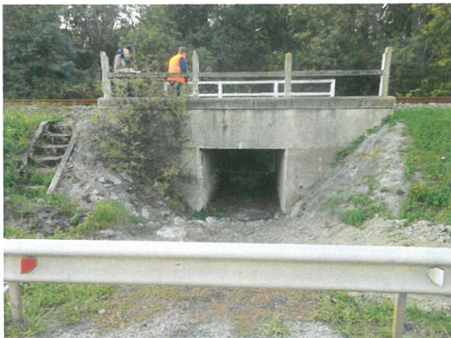
1. Vedere podeț din aval – culoare neuniformă, pete, exfolieri beton. Parapet de protecție cu mâna curenta lipsă. Scara de acces și pereu sferturi de con parțial distruse și acoperite de vegetație.
