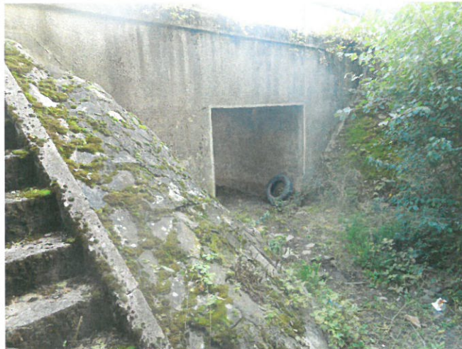
2. Vedere podeț din amonte – culoare neuniformă, pete, muchii ciobite, exfolieri beton. Scara de acces și pereu sferturi de con acoperite de mușchi și vegetație.
