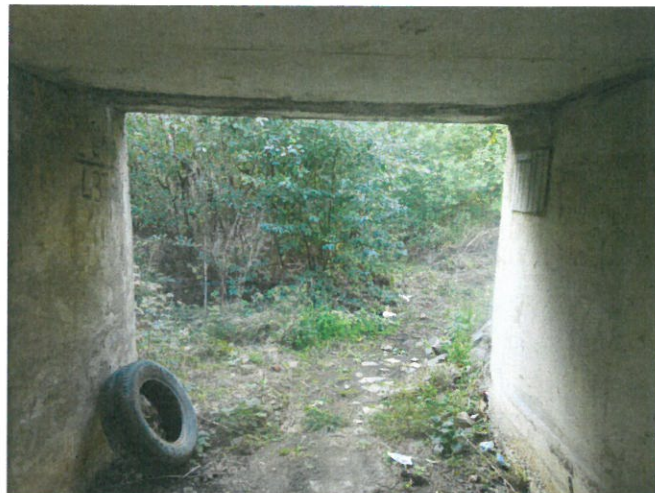
6. Vedere interior podeț spre amonte – culoare neuniformă, pete, infiltrații, exfolieri beton. Albie amonte neamenajată, vegetație crescută în albie, inclusiv arbuști și copaci.
