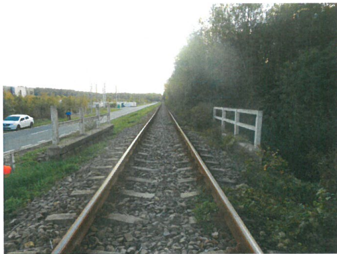
3. Vedere podeț spre Timișoara Est – parapet de protecție cu mâna curentă lipsă. Vegetație crescută în gabaritul căii ferate.
