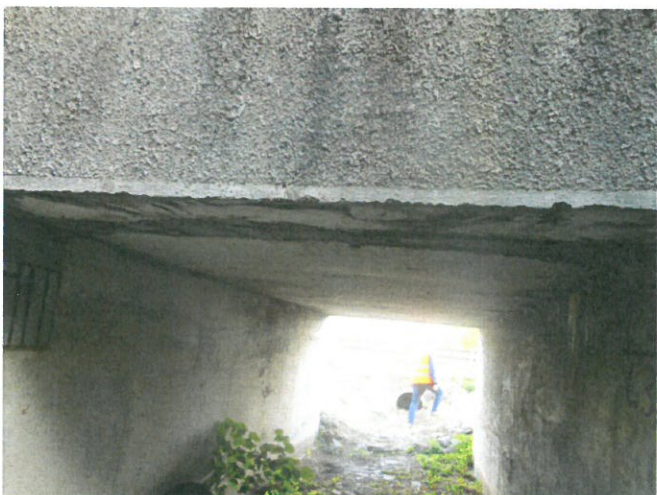
7. Vedere intrados podeț – culoare neuniformă, pete, infiltrații, muchii ciobite, exfolieri beton. Reparații betoane la intrados sunt făcute necorespunzător.
