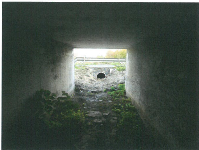
5. Vedere interior podeț spre aval – culoare neuniformă, pete, infiltrații, exfolieri beton. Gunoaie aruncate și vegetație crescută în podeț.
