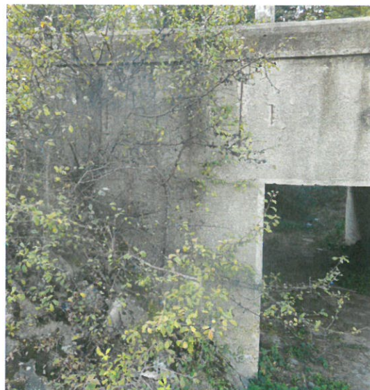
8. Elevație podeț din aval – culoare neuniformă, pete, muchii ciobite, exfolieri beton, armături ruginite și fără strat de acoperire. Arbuști crescuți pe sfertul de con.
