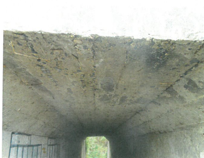
6. Vedere intrados podeț – culoare neuniformă, pete, infiltrații, muchii ciobite, segregări, exfolieri beton.
