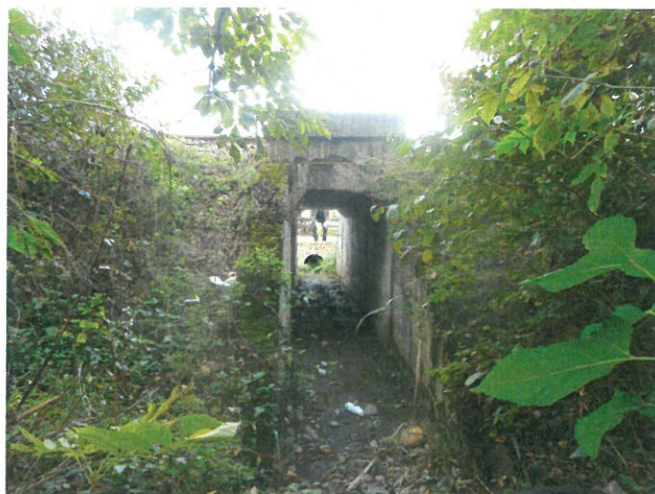
2. Vedere podeț din amonte – culoare neuniformă, pete, vegetație abundentă în zona podețului. Depuneri de aluviuni în podeț.
