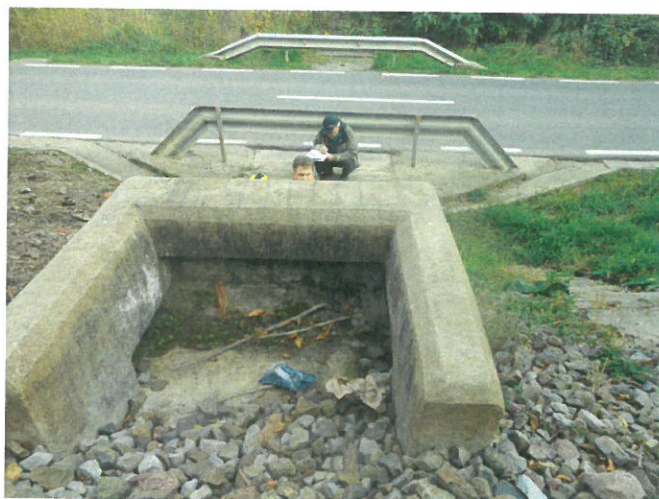
5. Timpan podeț aval – lipsă parapet de protecție, culoare neuniformă, pete, exfolieri beton.
