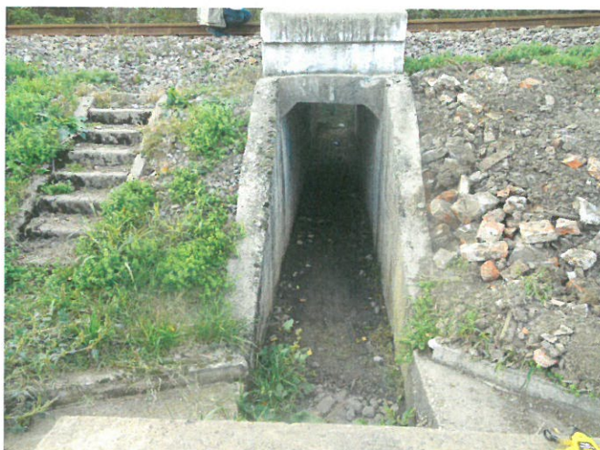
1. Vedere podeț din aval – culoare neuniformă, pete, muchii ciobite, exfolieri beton. Depuneri de aluviuni în podeț.
