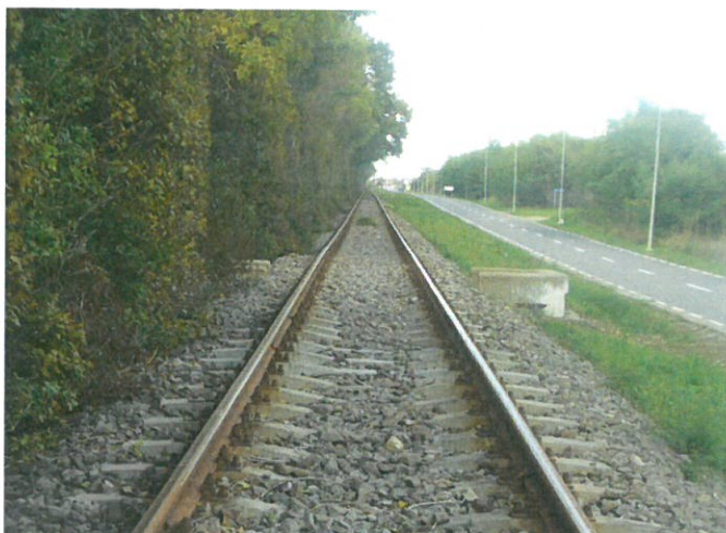
3. Vedere podeț spre Aeroport Traian Vuia – lipsă parapet de protecție, vegetație crescută în gabaritul căii ferate.
