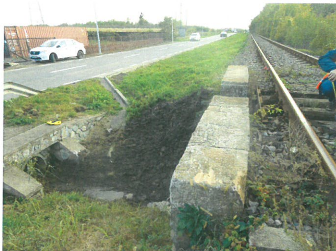
5. Vedere aval de podeț, racordare cu podețul de drum – tencuială degradată, vegetație crescută pe podeț, albie neamenajată.
