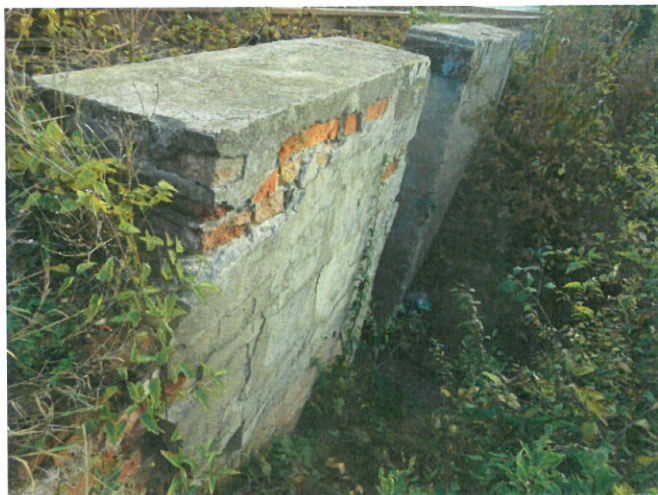
3. Vedere podeț din amonte – lipsă parapet de protecție, fisuri, crăpături în elevații, tencuială căzută, cărămizi dislocate. Vegetație crescută pe podeț și albie.
