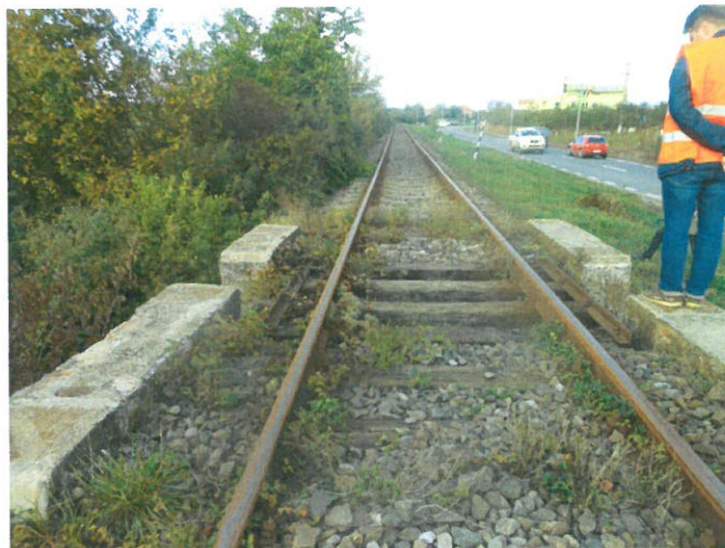
4. Suprastructura căii ferate pe podeț – lipsă parapet de protecție, traverse din lemn degradate, crăpate. Vegetație crescută pe podeț.
