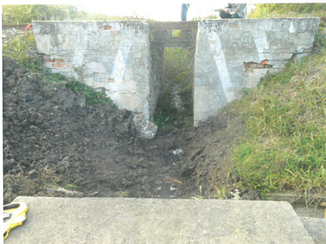
1. Vedere podeț din aval – lipsă parapet de protecție, fisuri, crăpături în elevații, tencuială căzută, cărămizi dislocate, albie neamenajată.
