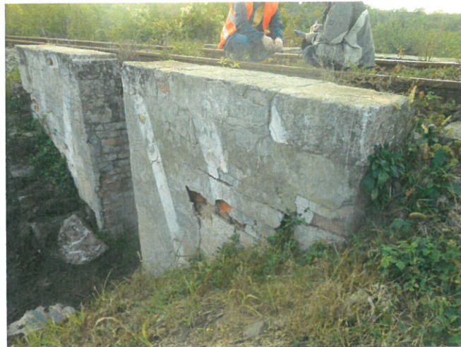
2. Vedere podeț din aval – lipsă parapet de protecție, fisuri, crăpături în elevații, tencuială căzută, cărămizi dislocate, scară de acces degradată. Vegetație crescută pe podeț.
