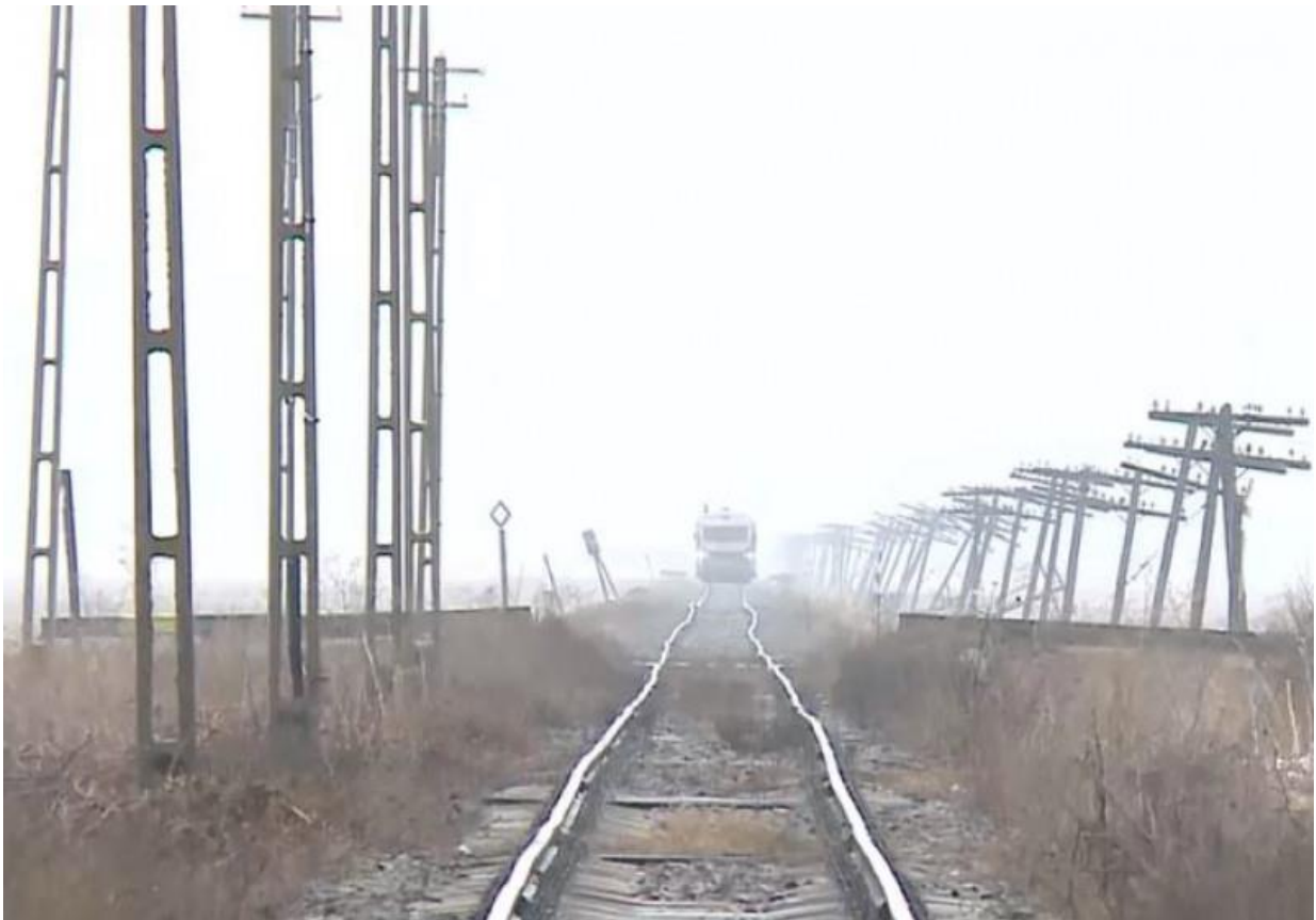
Exemplul unui efect direct al schimbărilor climatice asupra unui aliniament de cale ferată (sursa: Stiridecluj.ro/Digi24 )
