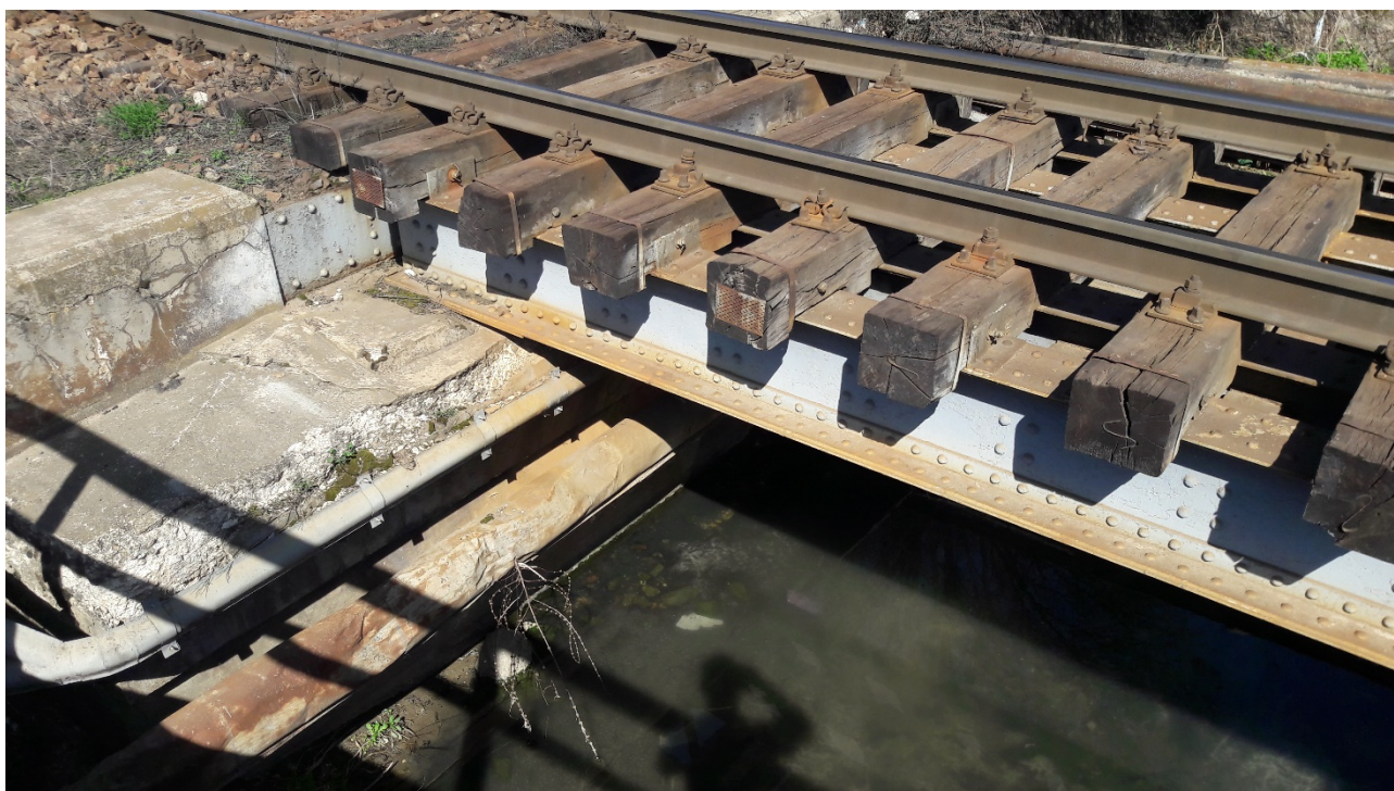
Figura 3: Pod 5÷10 m, km 286+542 (Anul de construcție 1970)
