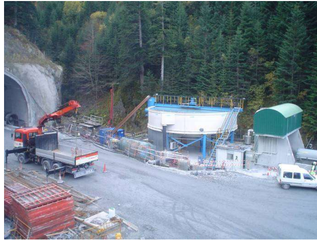
Photo 3.6.a.- Exemplu unei statii de filtrare la portale.
