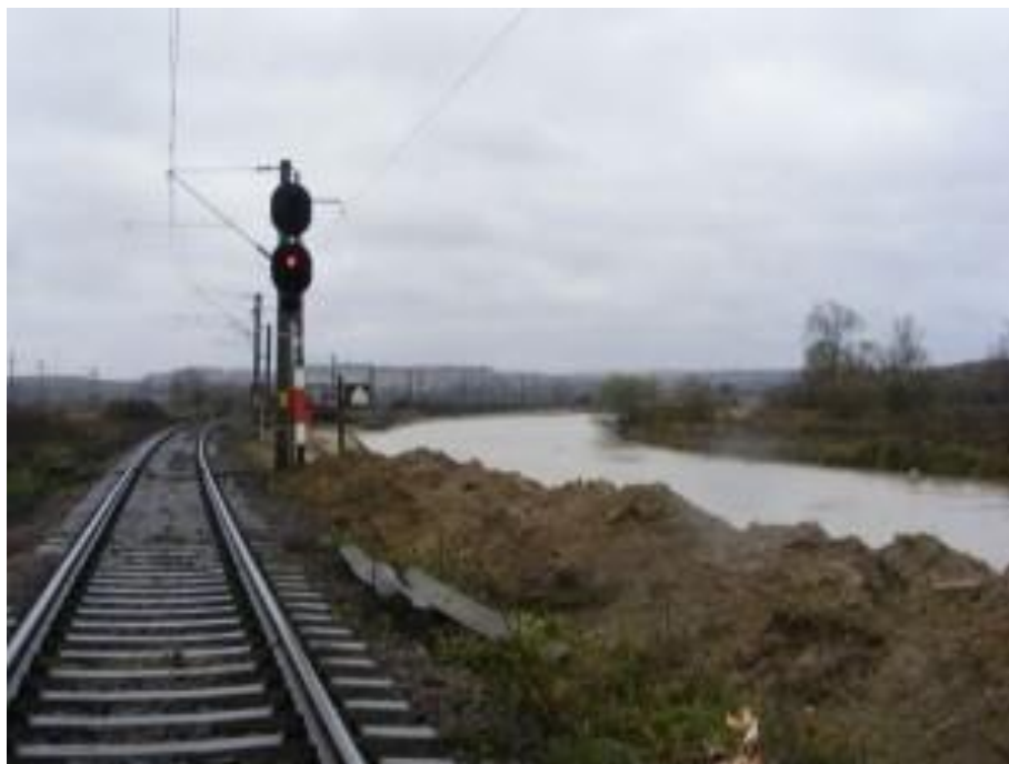
Figura 12: Inundații ale râului Motru in sectorul Drobeta-Turnu Severin - Strehaia, între stațiile Igiroasa și Prunișor (04.05.2014)
