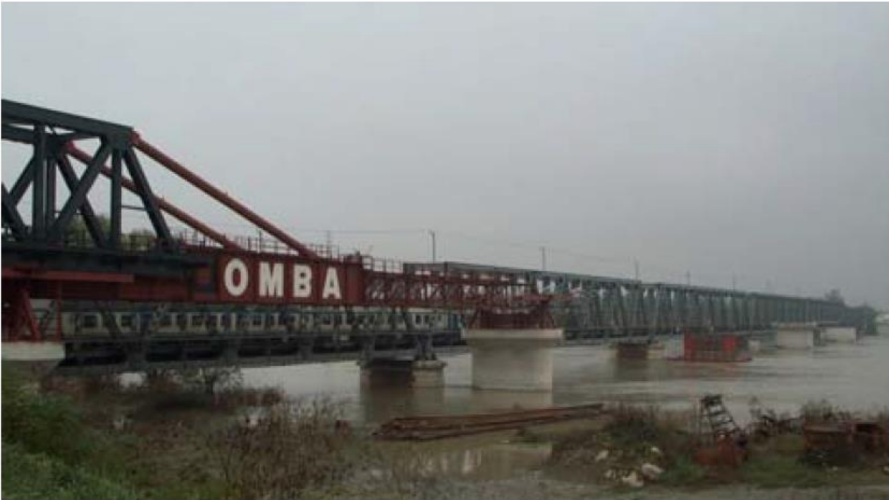
Figura 26: Exemplu de lansare prin împingere a tablierului de cale ferata în situația de nivel ridicat al apelor ( raul Po Italia)
