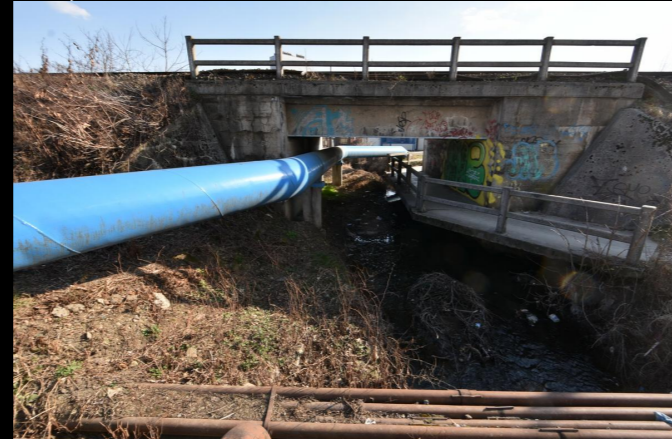
pod feroviar peste Canalul Morii la Clujana, cuplat cu pasaj pietonal și infrastructură parazitară
