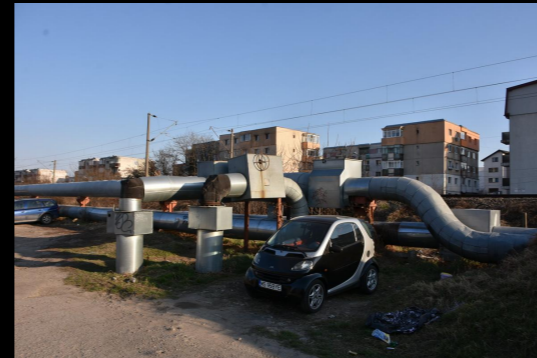
hidraulica aeriană de termoficare
