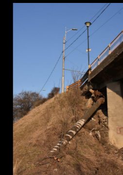
traversare magistrală apă, iluminat redundant, uzat
