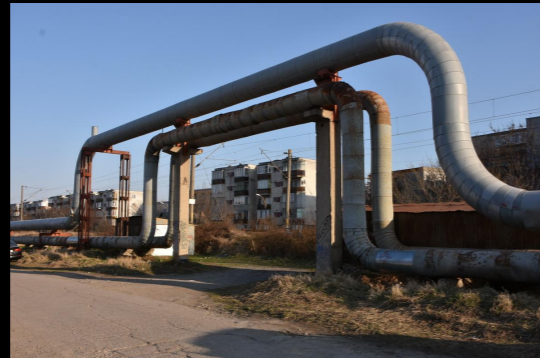
rețea termoficare și ACM cu lire de dilatare în peisaj
