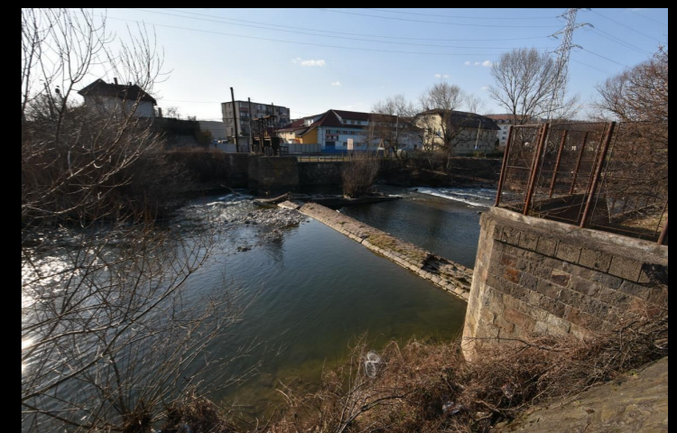
stăvilarul de captare de apă al Gării Centrale Cluj - râul Someșul Mic, strada Oașului
