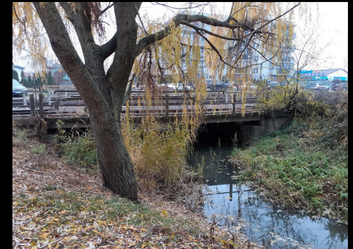
pod feroviar peste pârâul Becaș, colmatare și lipsă de întreținere
