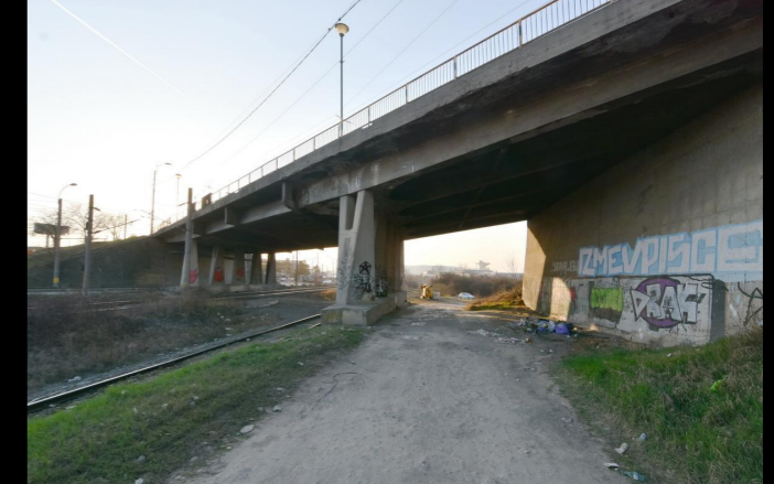
podul IRA peste cale ferată, cu segmente de pasaj carosabil lateral subdimensionate, tronsonul median al structurii reazămă pe console
