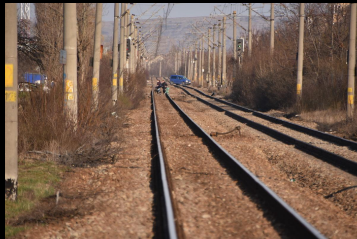
cale ferată neîntreținută tehnic și în privința anturajului vegetal, deșeuri, lipsa îngrădirii, viteză mică, zgomot, risc sport
